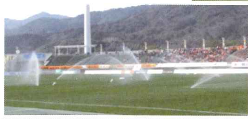
フィールド自動散水装置
